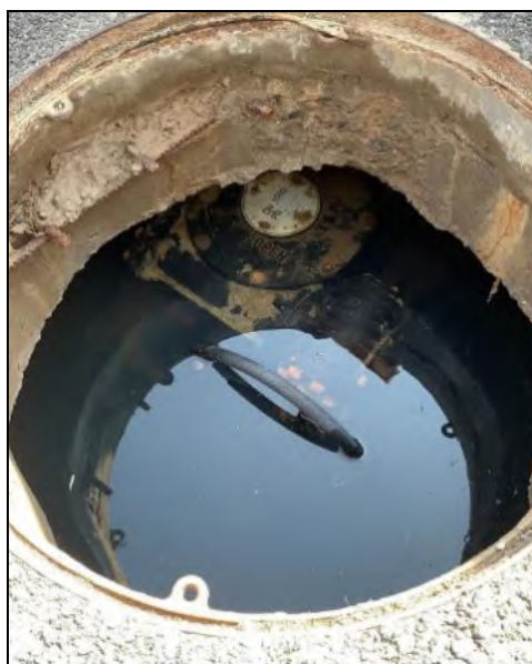
图 5.5-3 雨水切换阀建设情况
