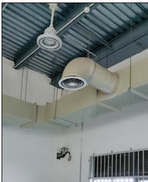
图 5.4-6 危废仓库废气收集口
