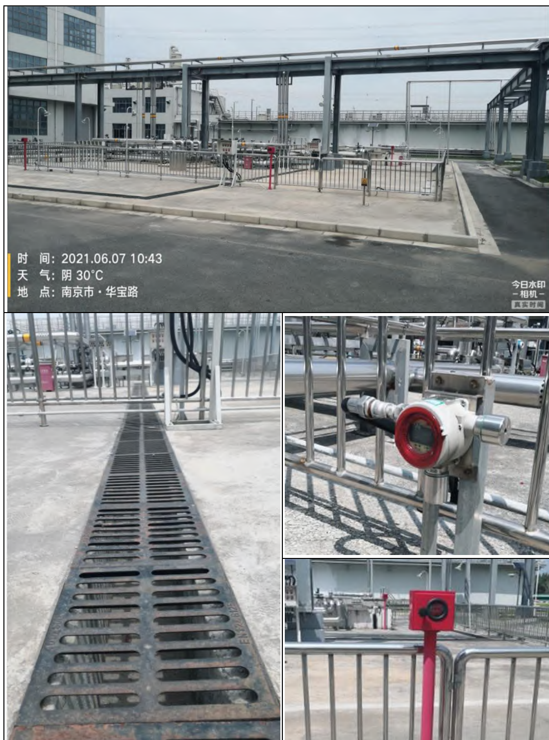
图 5.5-1 罐区环境风险防控措施建设情况
