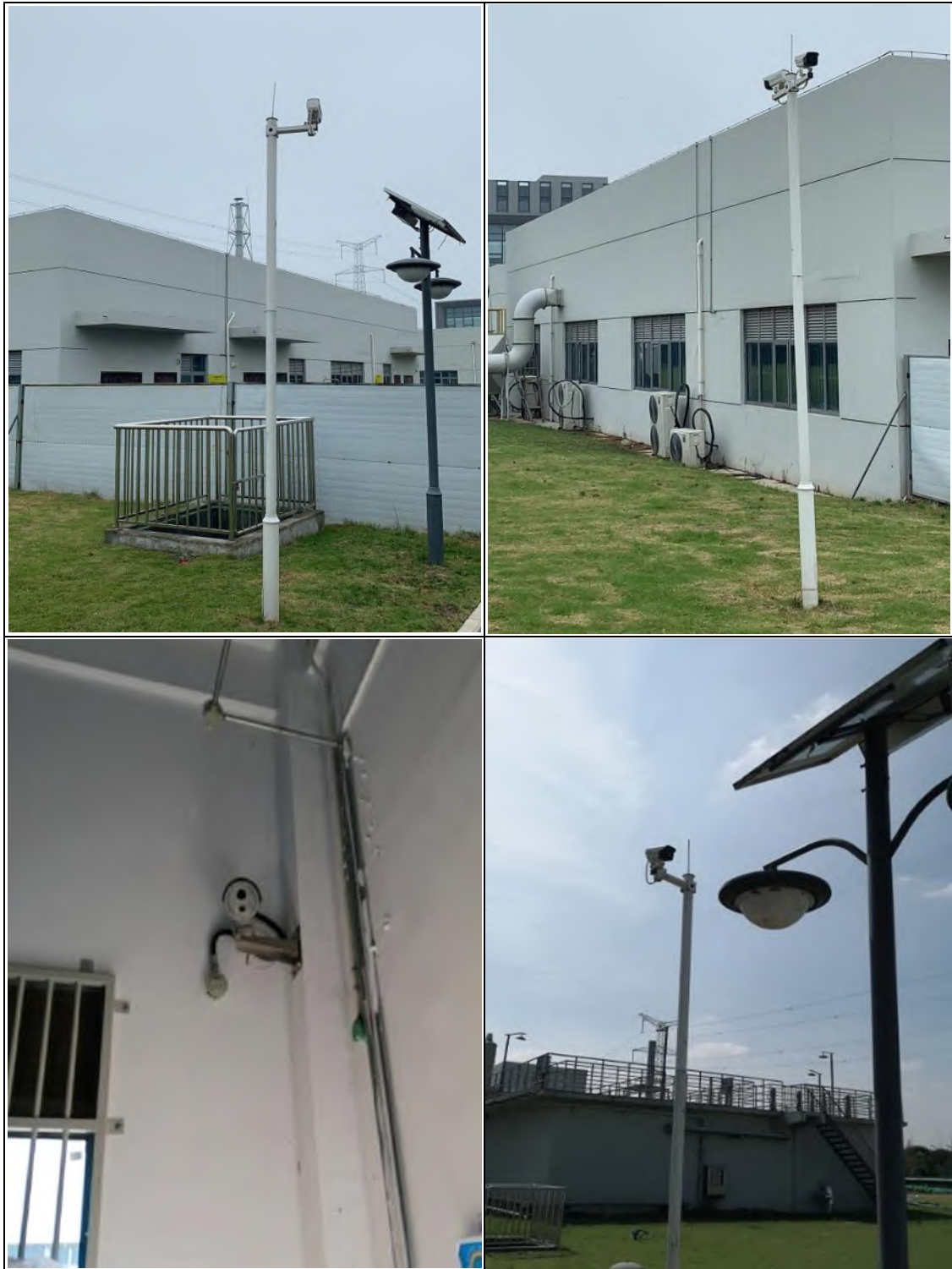
危废仓库内外视频监控设施
