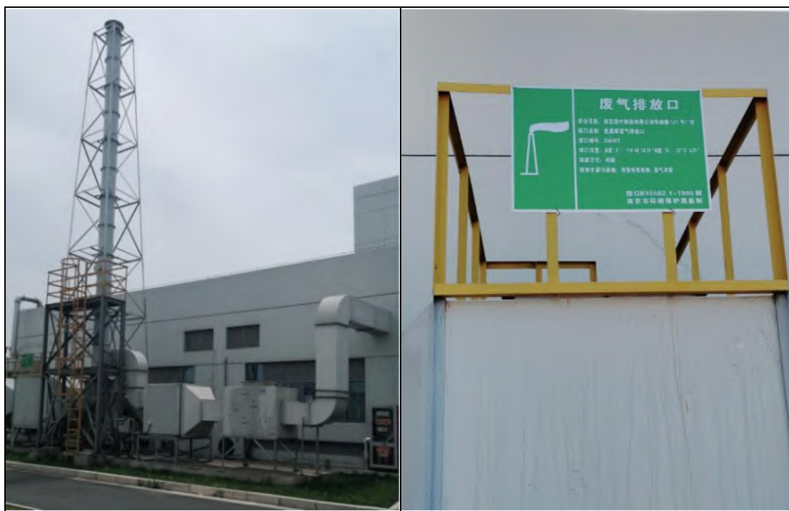
图 5.1-6 储罐有机废气治理设施及排气筒标志
