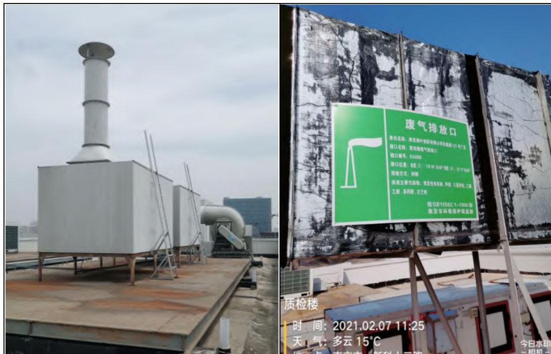
图 5.1-5 质检楼有机废气治理设施及排气筒标志
