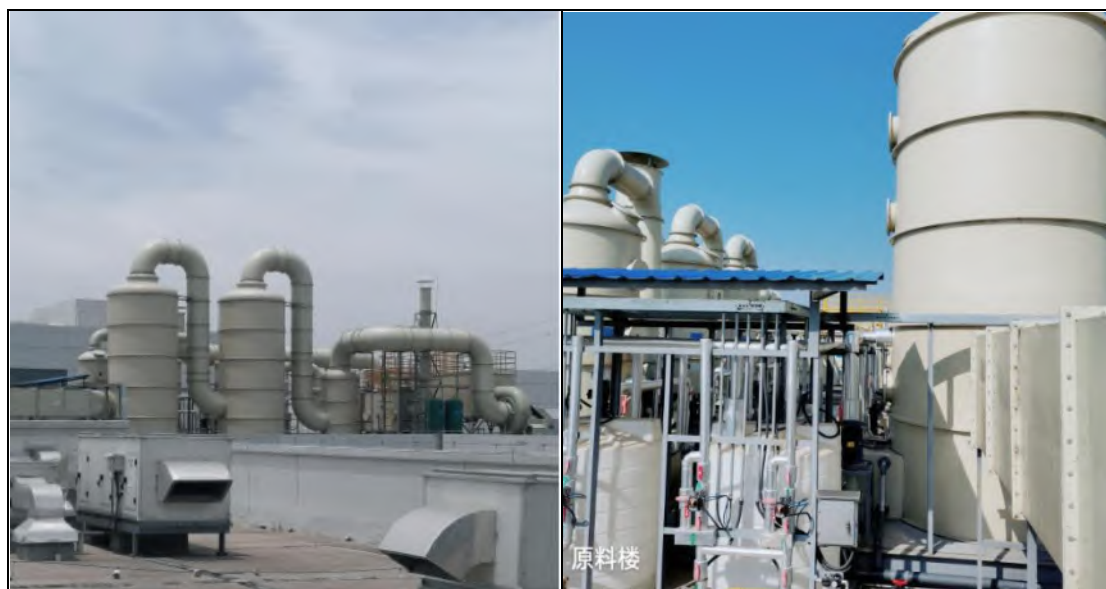
图 5.2-2 原料楼一碱性有机废气治理设施及排气筒标志
