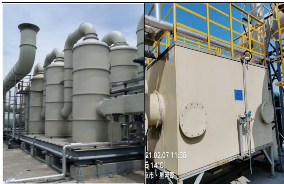
图 5.2-3 原料楼一酸性有机废气治理设施
