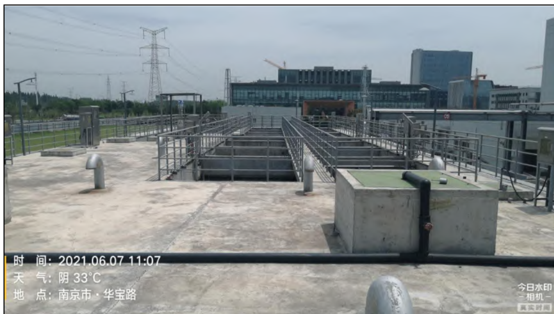
图 5.1-6 污水处理站生化处理系统
