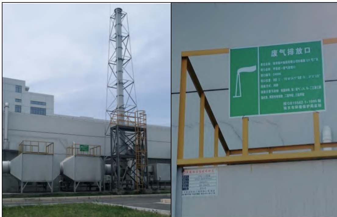
图 5.1-7 甲类库一废气治理设施及排气筒标志
