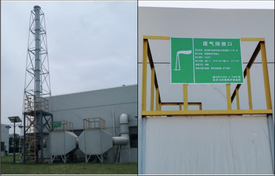
图 5.1-8 危废暂存有机废气治理设施及排气筒标志
