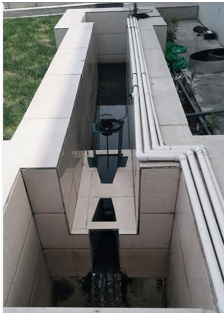
图 5.5-6 污水排放口监控取样池
