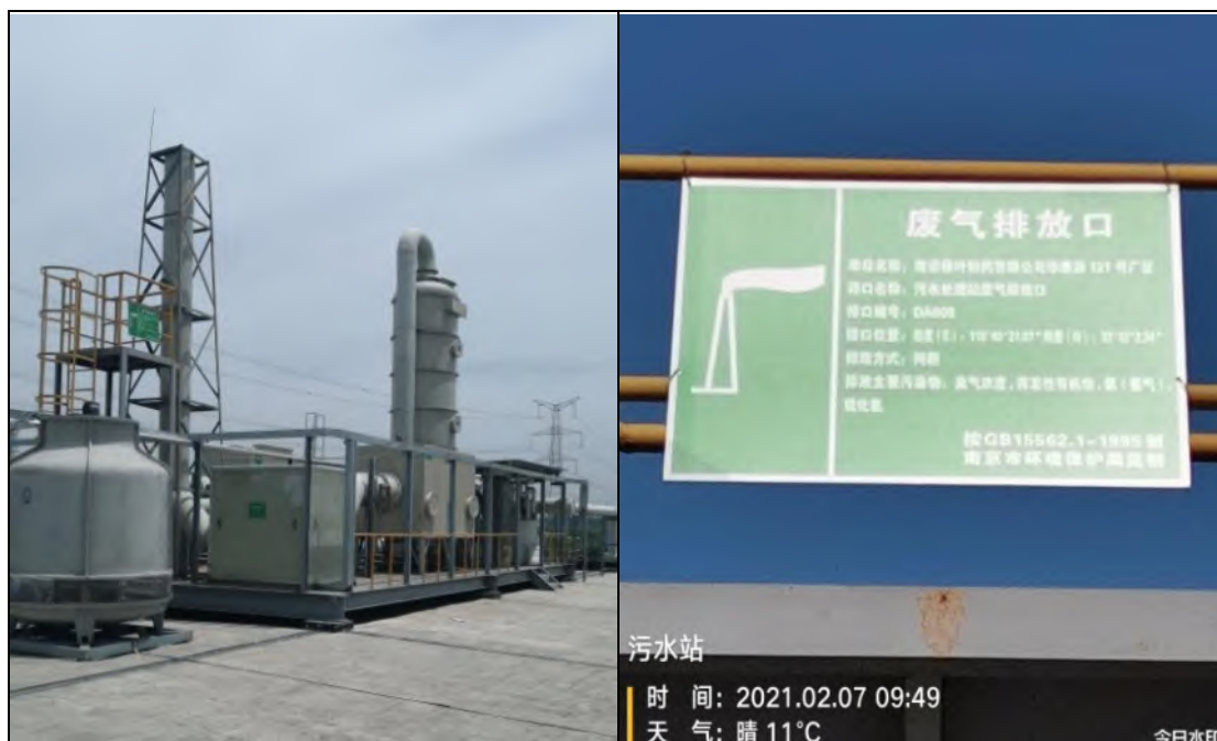
图 5.1-4 污水处理站废气治理设施及排气筒标志
